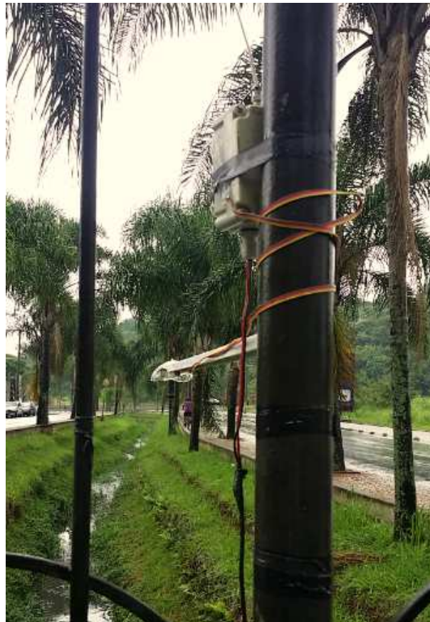
Figura 23. Sensor Instalado em Ponto Crítico do Córrego em Poá.
