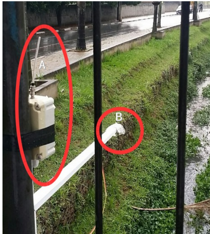
Figura 21: Sensor instalado em córrego de Poá-SP com (A) antena de comunicação e (B) sensor ultrassônico
