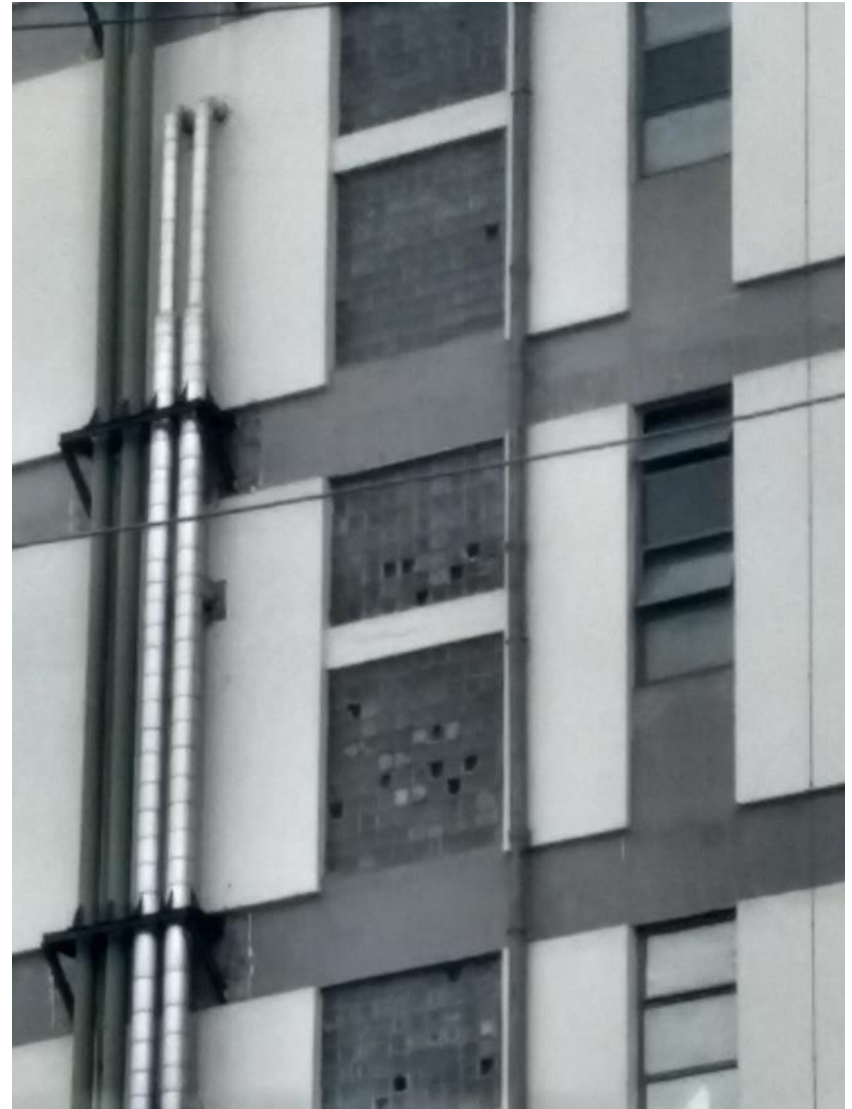
Figura4.6: Edifício com as janelas depredadas. Fonte: Foto da autora, Nov. 2018.
