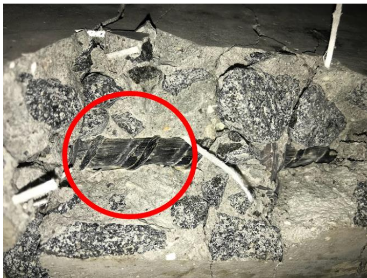
Figura 51. Detalhe da ruptura da barra.
