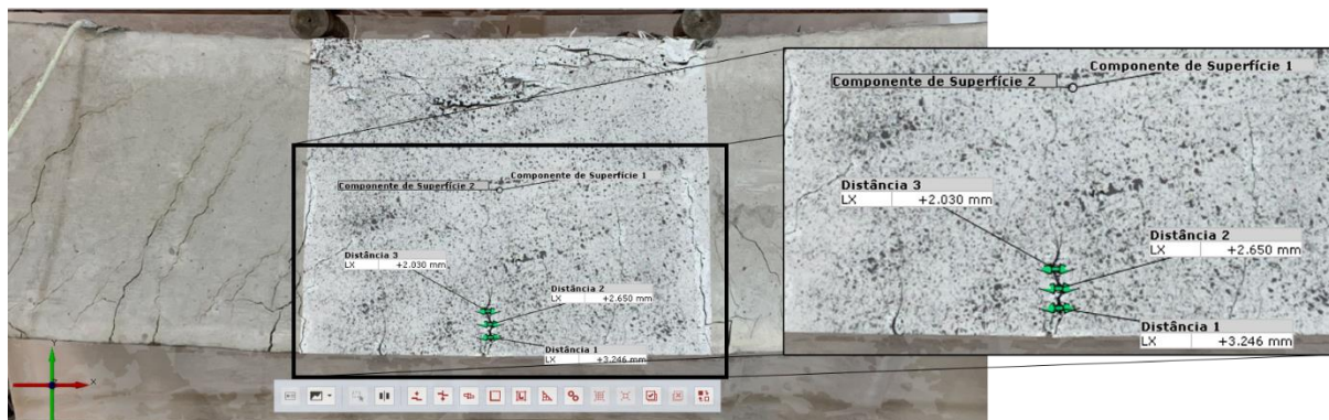
Figura 59. Leitura da abertura de fissura da viga B-F-SC.
