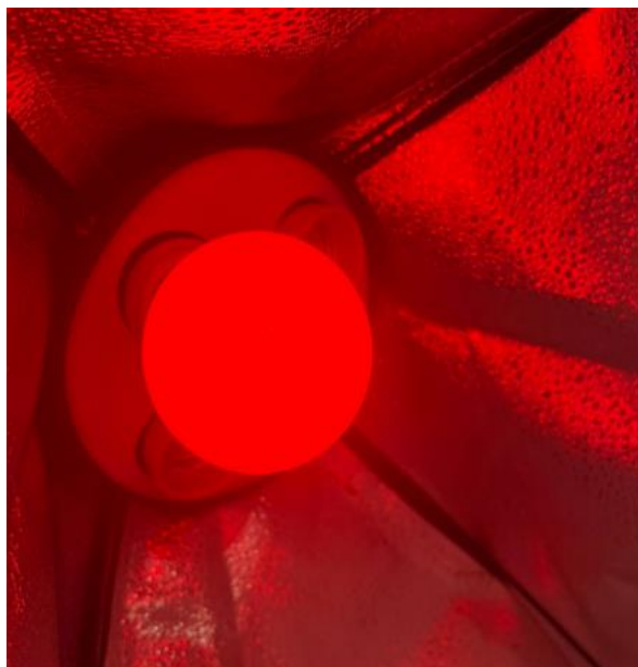
Figura 60 - Lâmpada de emergência acesa a com o estado da porta aberta
