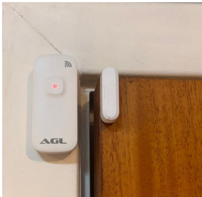
Figura 53 - Sensor de abertura detectando a abertura porta Fonte: Autoria Própria, 2023
