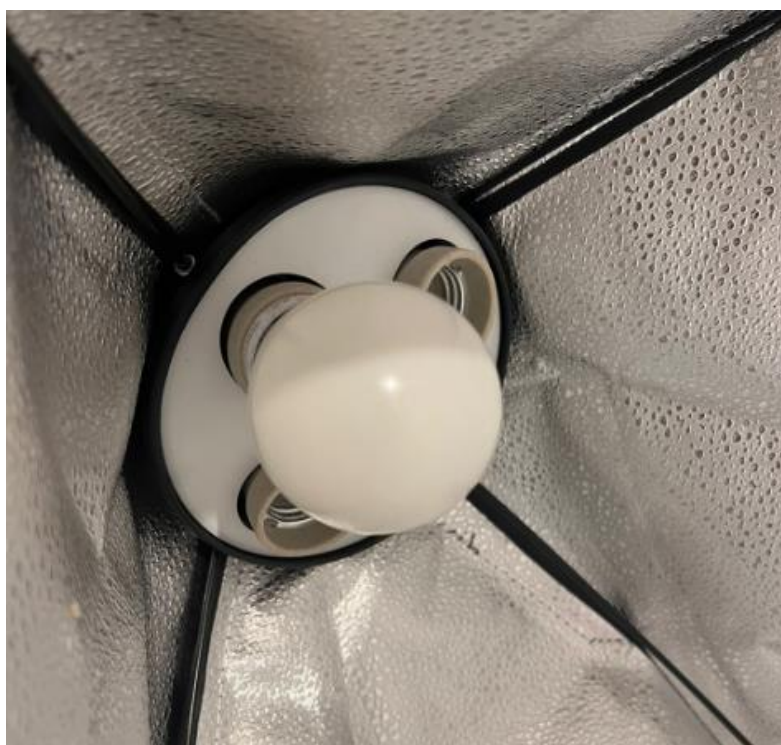
Figura 50 - Lâmpada de emergência instalada com o estado da porta fechada Fonte: Autoria Própria, 2023
