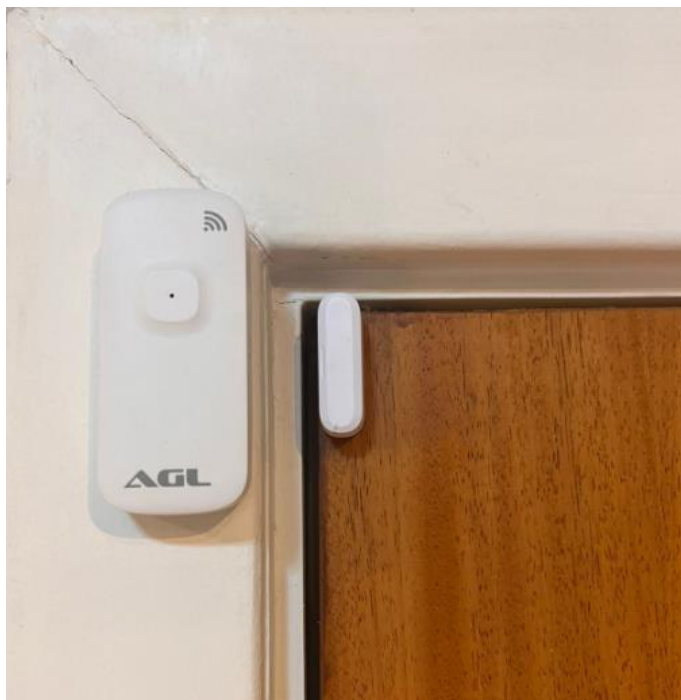
Figura 49 - Sensor de abertura instalado na porta fechada Fonte: Autoria Própria, 2023
