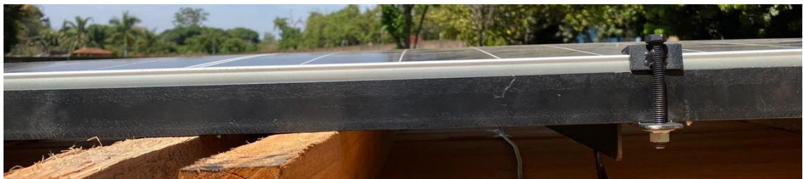
Figura 55. Estufar do sistema fotovoltaico
