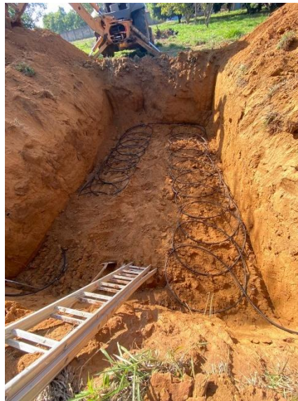
Figura 35. Espaço do trocador de calor
