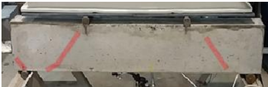
Figura 6.89 – TFRES SE – detalhes fissuras
