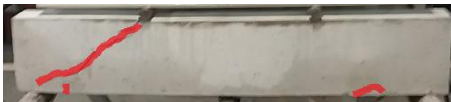
Figura 6.107 – TFAI SE – detalhes fissuras
