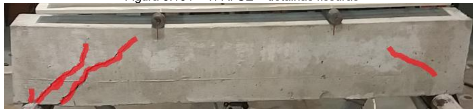
Figura 6.104 – TFAI CE – detalhes fissuras
