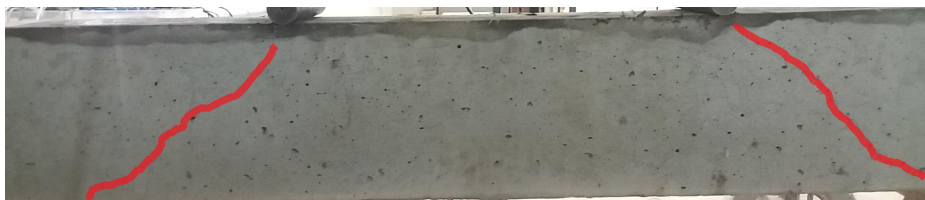
Figura 6.98 – TfvII CE – detalhes de fissuras
