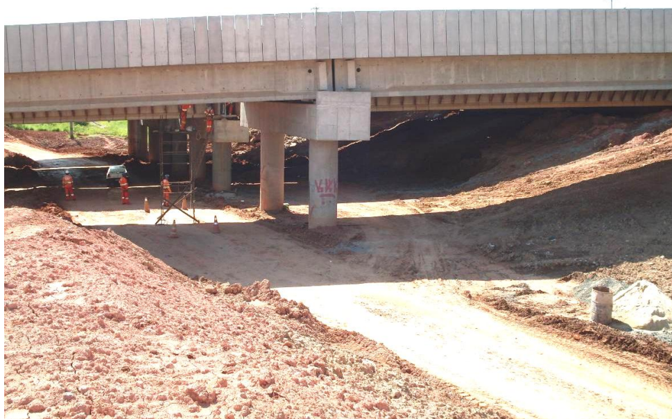
Fig. 37 - Ao se encontrar com a rodovia Anhanguera, obras viárias interrompem o trajeto dos trilhos e a continuidade do espaço ferroviário. Fonte: Pablo Costa. Campinas 2009
