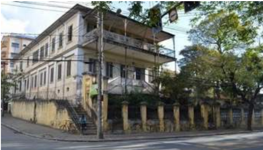
Figura 55: Imagem de 2016 do Sobrado do Conde Prates, já como bem tombado. A imagem retrata a ampliação realizada nos anos de 1940 e a presença da varada frontal. Na imagem é notável o mau estado de conservação do edifício. Fonte: Acervo da pesquisa.
