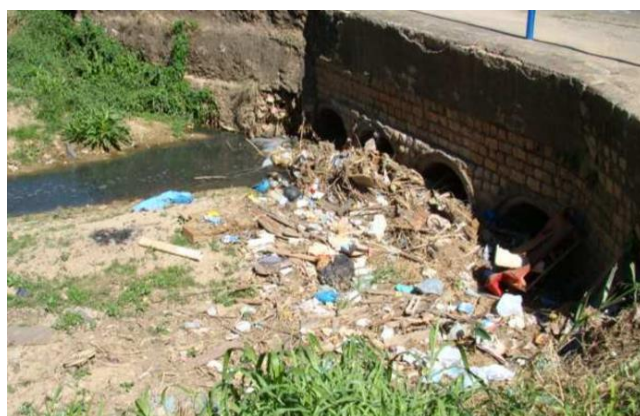
Figura 9: Galerias subdimensionadas e acúmulo de lixo Fonte: Companhia de Pesquisa em Recursos Minerais (2013)
