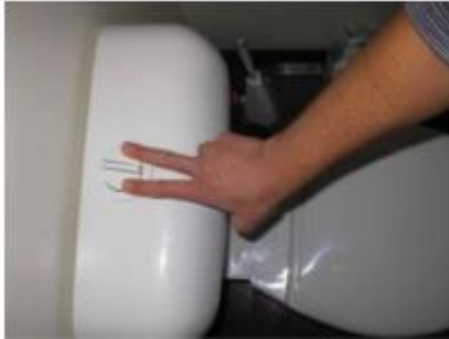
Figura 10 – CEEWH: Instalação de vasos com caixa acoplada e sistema duplo de acionamento.
