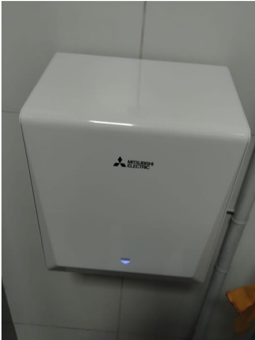
Figura 19 – SESC CEDEI: Aparelhos para secar a mão com ventilação em vez de papel Fonte: foto tirada pelo autor
