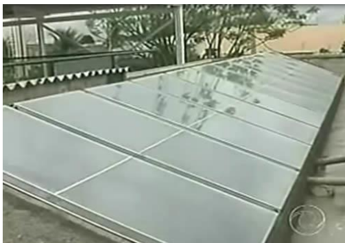
Figura 13 – CEEWH: Coletores solares para aquecimento de chuveiros no vestiário
