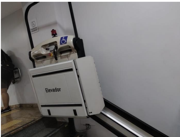
Figura 5 – SESC CEDEI: Elevadores para a acessibilidade Fonte: foto tirada pelo autor
