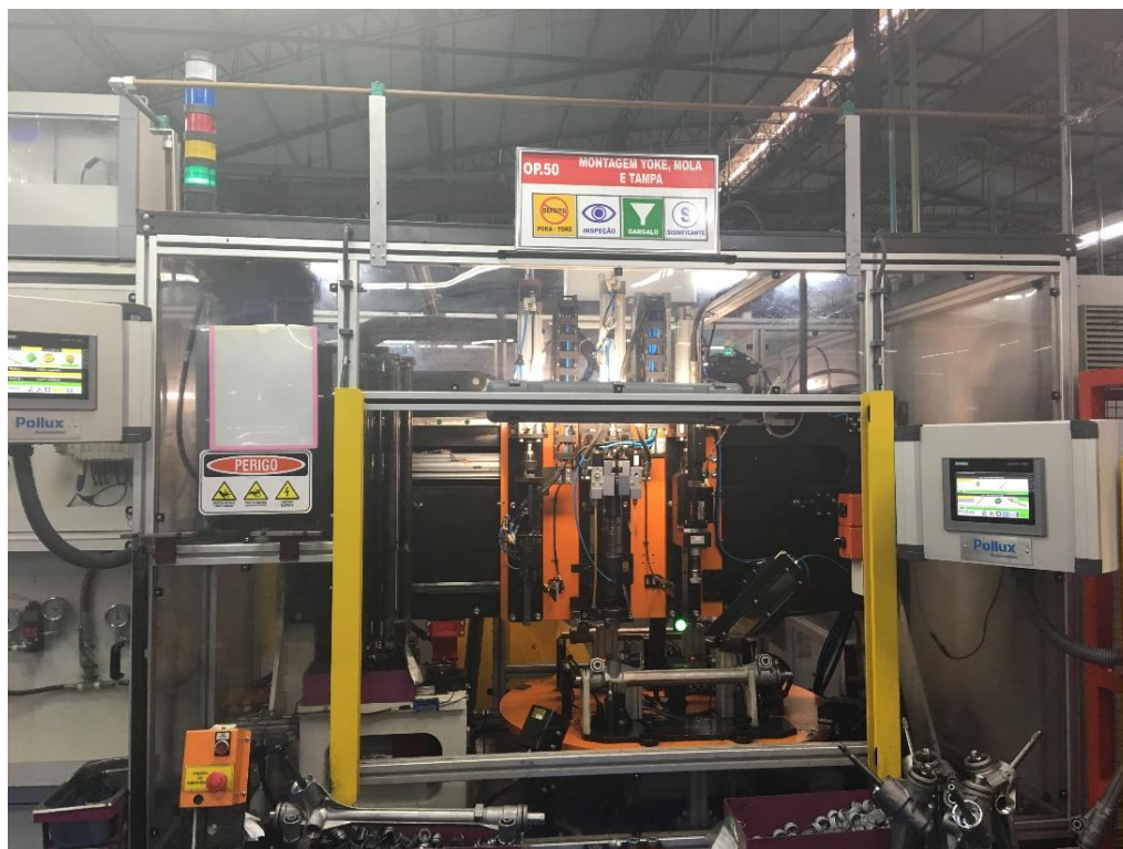
Figura 18 – Lado OP50 da estação OP50-60 da linha MSG com sua IHM.
