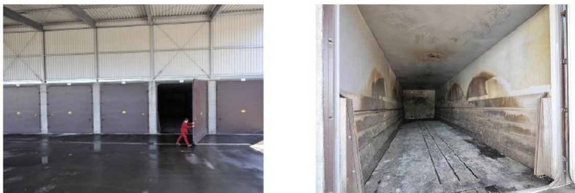
Figura 8: Imagens dos túneis de digestão anaeróbia.
