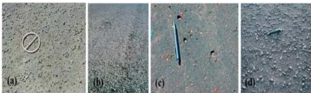
Figura 5 – Degradação da camada por desgaste (a), desagregação de agregado (b), deslocamento e perda de agregado (c) e polimento de agregado (d)
