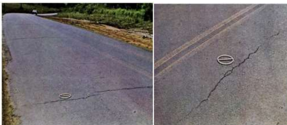
Figura 6 – a. Trinca isolada transversal em pavimentos flexíveis; b. Trinca isolada longitudinal em pavimentos flexíveis
