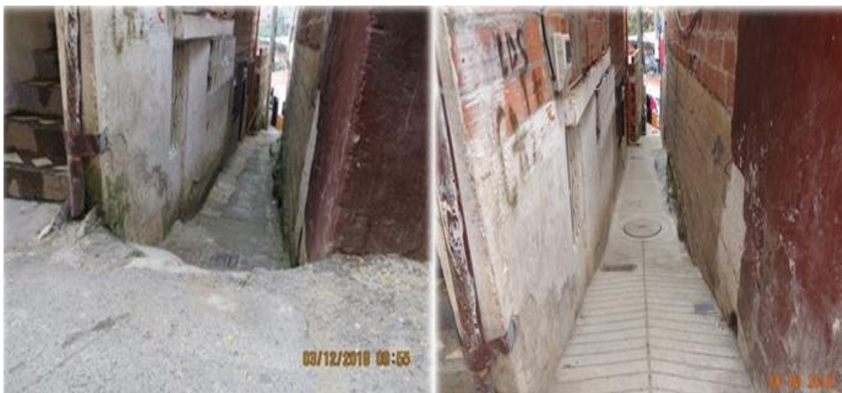
Figura 28 - Antes e depois do Programa Unidos por el Agua no bairro Las Estancias – Villa Turbay, na Comuna 8. Rede de esgoto cruzando viela e conectando as moradias, em 2018.
