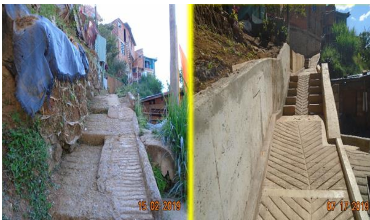
Figura 29 - Antes e depois do Programa Unidos por el Agua no bairro Santo Domingo – Setor La Torre, na Comuna 1. Melhorias urbanas após a conexão de moradias, em 2019.
