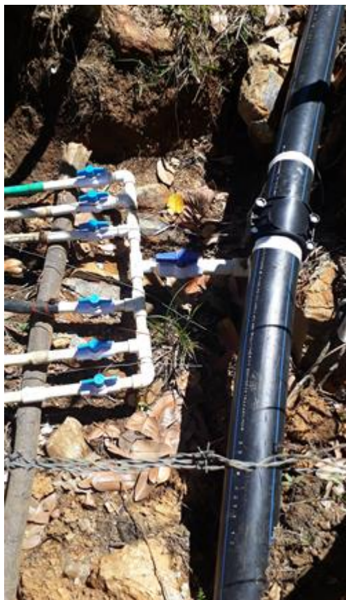
Figura 34 - Colar de tomada e distribuição de água para as moradias “irregulares” de Bello Oriente a partir da adutora comunitária
