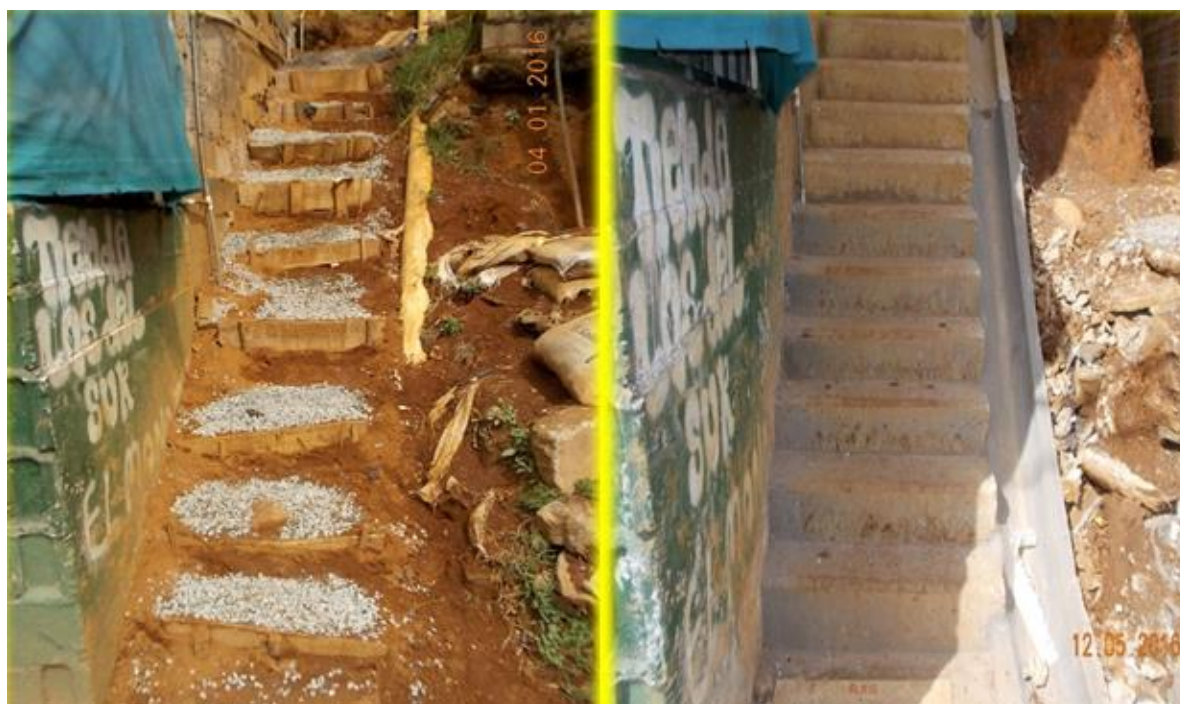
Figura 27 - Antes e depois do Programa Unidos por el Agua no bairro Carpinelo, Comuna 1, em 2016. Rede de esgoto instalada em escadaria, como solução não convencional na modalidade Abastecimento Comunitário
