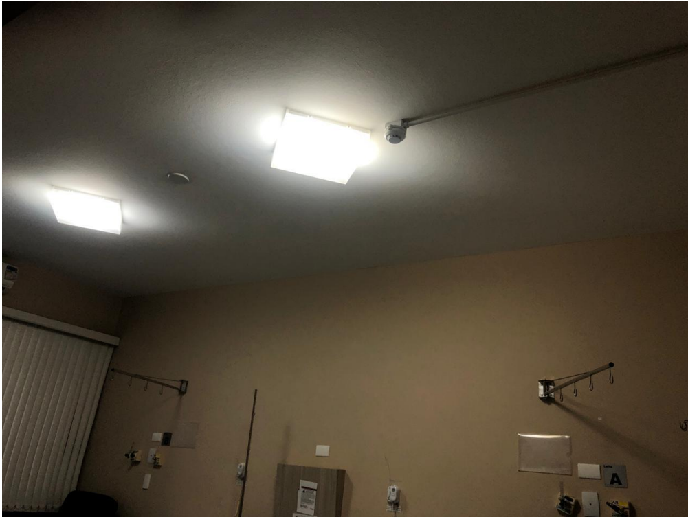
Figura 49 – Iluminação artificial quarto de internação 16 Hospital Samaritano de Campinas – Fonte: Acervo da autora
