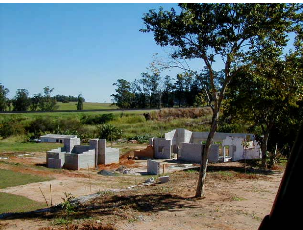
Obra abandonada pela construtora. 2003
