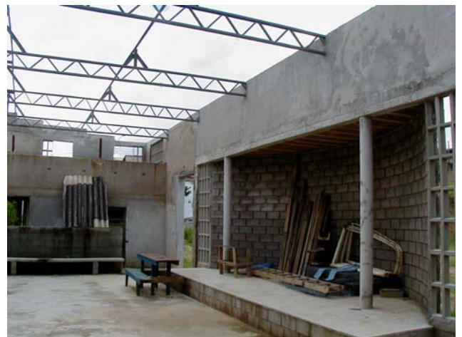
Obra abandonada pela construtora. Salão comunitário. 2003
