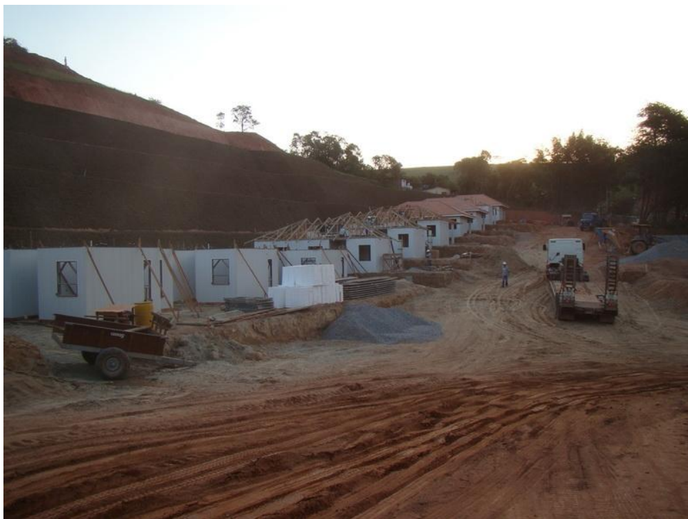
Figura 46 – Construção de casas da CDHU. Fonte: Relatório Técnico do IPT, 2010. Disponível em: http://www.saoluizdoparaitinga.sp.gov.br/site/a-cidade/planejamento-ceresta/parceiros-da-reconstrucao/ Acesso em: 06/05/2013.
