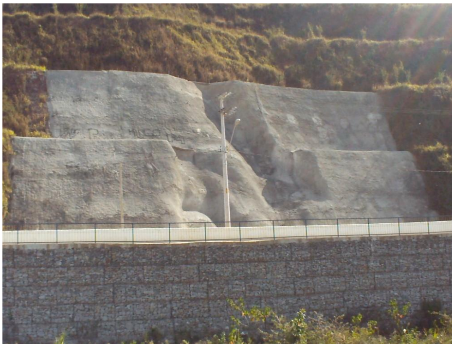
Figura 26. Área de escorregamento de solo após intervenção de jateamento de concreto para contenção. Fonte: Levantamento próprio, julho de 2012.
