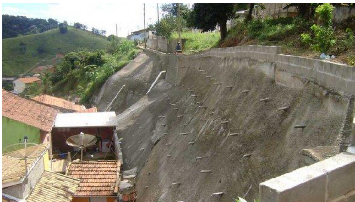
Figura 28: Mesma área da foto anterior após a intervenção de jateamento de calda de cimento sobre área suscetível a novo deslizamento de solo. Fonte: Relatório Técnico do IPT, disponível em: http://www.saoluizdoparaitinga.sp.gov.br/site/a-cidade/planejamento-ceresta/parceiros-da-reconstrucao/ Acesso em: 06/05/2013.
