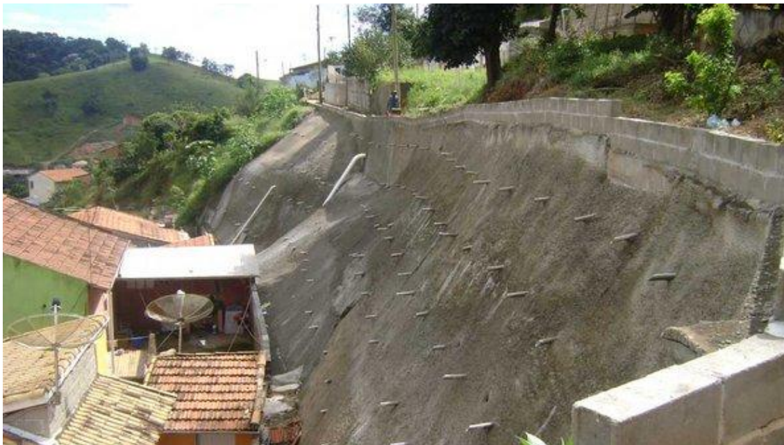
Figura 28: Área extremamente inclinada, frágil do ponto de vista geológico, após a intervenção de jateamento de calda de cimento. Fonte: Relatório Técnico do IPT, disponível em: http://www.saoluizdoparaitinga.sp.gov.br/site/a-cidade/planejamento-ceresta/parceiros-da-reconstrucao/ Acesso em: 06/05/2013.
