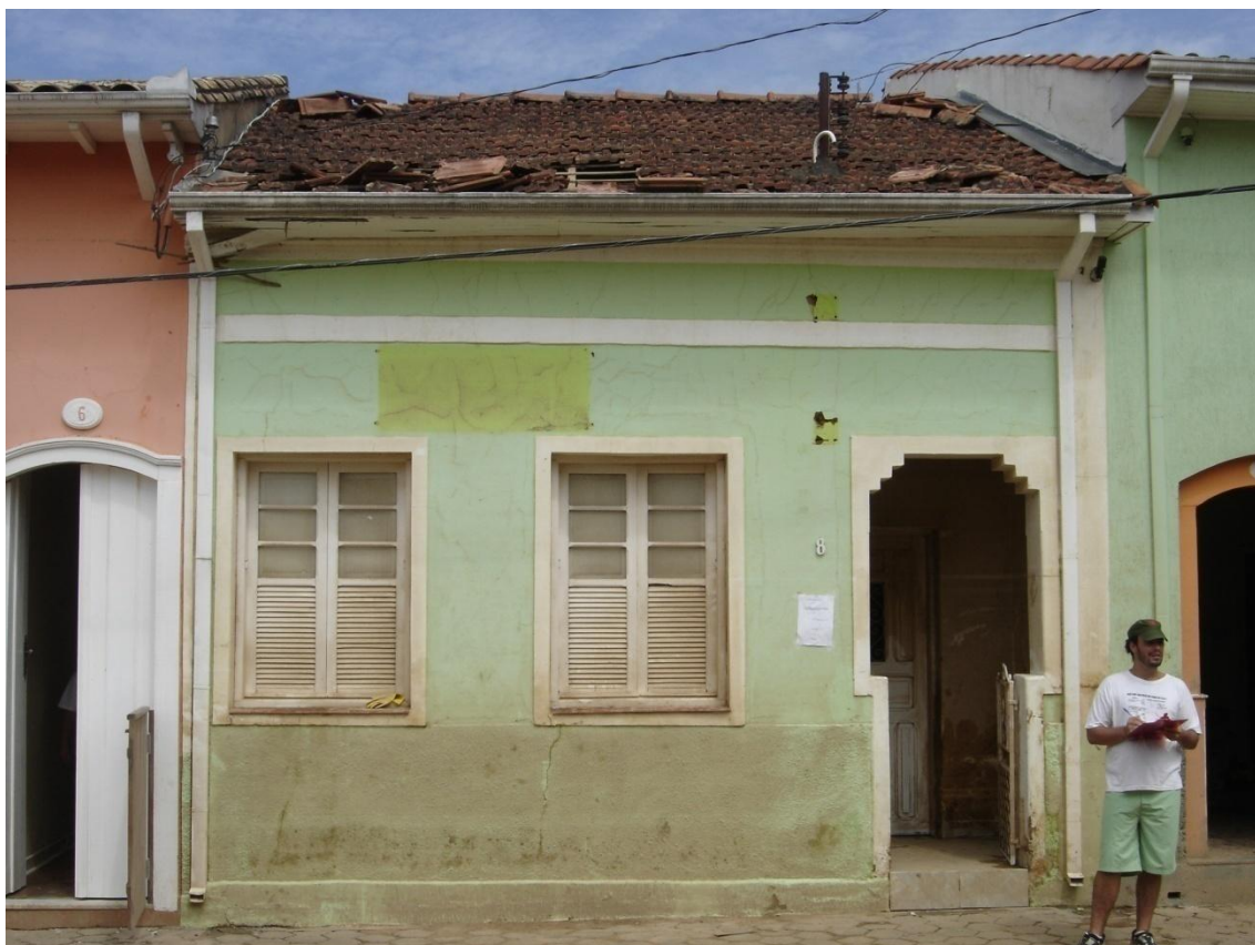
Figura 34: Casa 8 na Rua Barão de Paraitinga em foto tirada para cadastro da Prefeitura sobre imóveis atingidos ou não, e liberados ou interditados. É possível ver a folha da avaliação do IPT colada na parede ao lado do acesso à residência. Na imagem, um dos voluntários preenche ficha fornecida pela Prefeitura, durante levantamentos realizados nos dias 08 e 22 de janeiro. Fonte: Levantamento próprio, janeiro de 2010.
