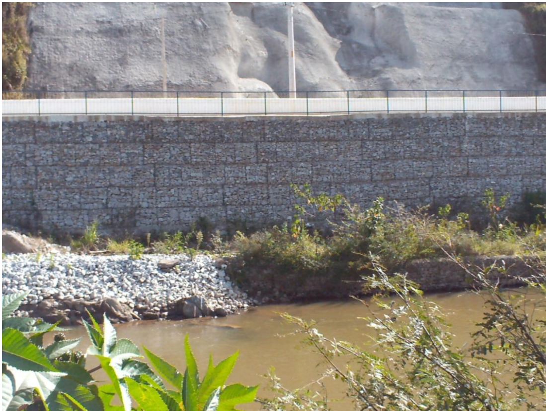
Figura 29: Trecho urbano do Rio Paraitinga onde é possível ver: camada de rachão na interação talude/rio para viabilizar o muro de gabião atrás, protegendo via de circulação que já conta com intervenção de jateamento de cimento sobre talude. Fonte: Levantamento próprio, julho de 2012.
