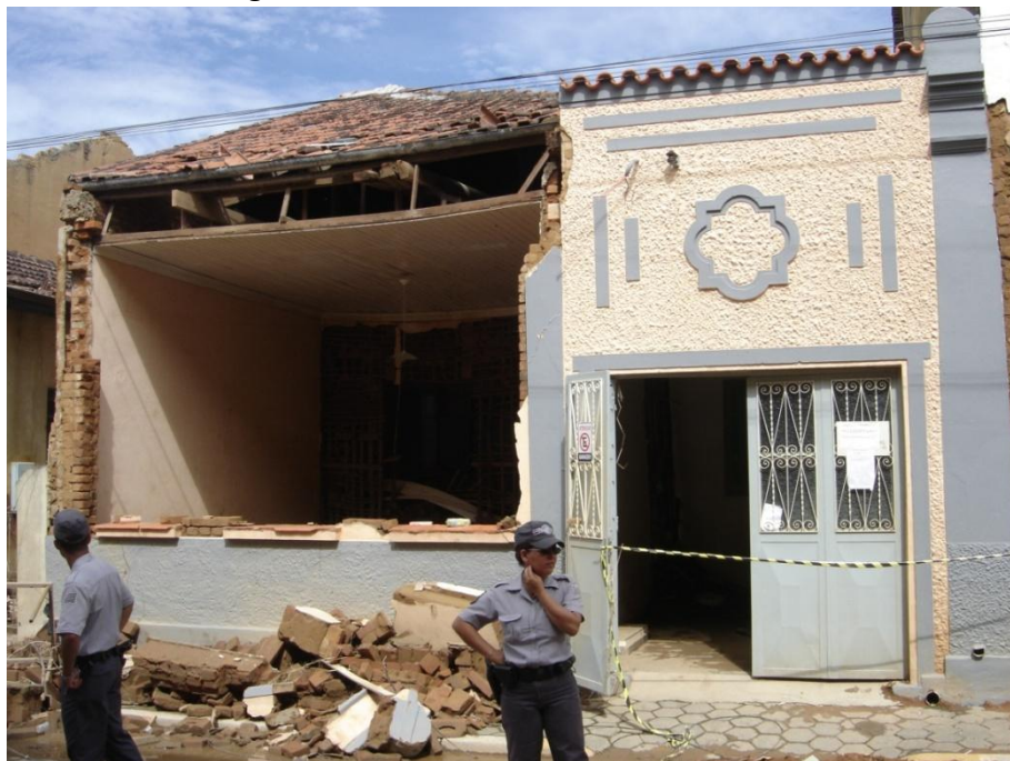
Figura 20 – Residência de frente para a Praça Oswaldo Cruz onde se destaca a parede frontal, devassada com a enchente, e executada em alvenaria de tijolos cerâmicos vistos no que permaneceu da parede. Fonte: Levantamento próprio, janeiro de 2010.
