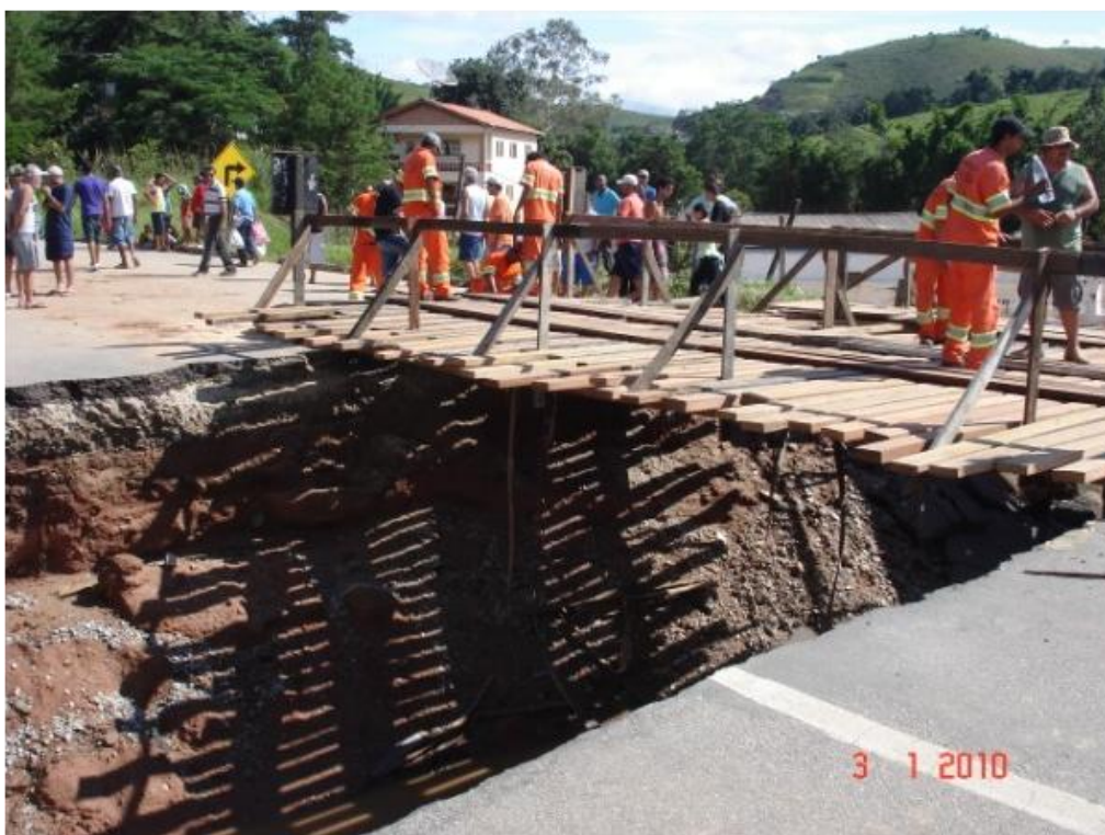
Figura 22 – Acesso temporário para entrada em São Luiz do Paraitinga, foto do dia 3 de janeiro de 2010. Fonte: Relatório Técnico do DAEE, disponível em: http://www.saoluizdoparaitinga.sp.gov.br/site/a-cidade/planejamento-ceresta/parceiros-da-reconstrucao/ Acesso em: 06/05/2013.
