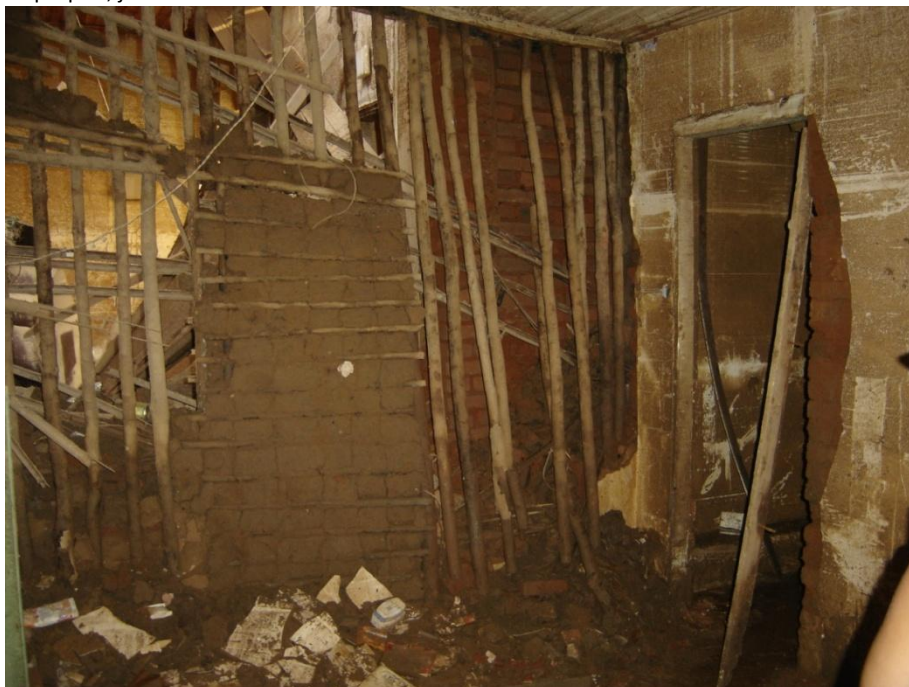
Figura 21 – Foto interna de residência na Rua Barão de Paraitinga, onde se destaca a parede em taipa seriamente danificada, em um cenário comum aos imóveis no mês da enchente com muita lama. Fonte: Levantamento próprio, janeiro de 2010.
