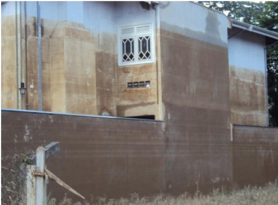
Figura 16 – Residência marcada pelo barro do Rio Paraitinga, deixando visível o nível da água. Foto de 7 de janeiro. Fonte: Relatório Técnico do DAEE. Disponível em: http://www.sobrade.com.br/Apresentacoes%20seminario/Apresenta%C3%A7%C3%A3o%20-Marli%20Reis%20-%20DAEE.pdf Acesso em: 06/05/2013.
