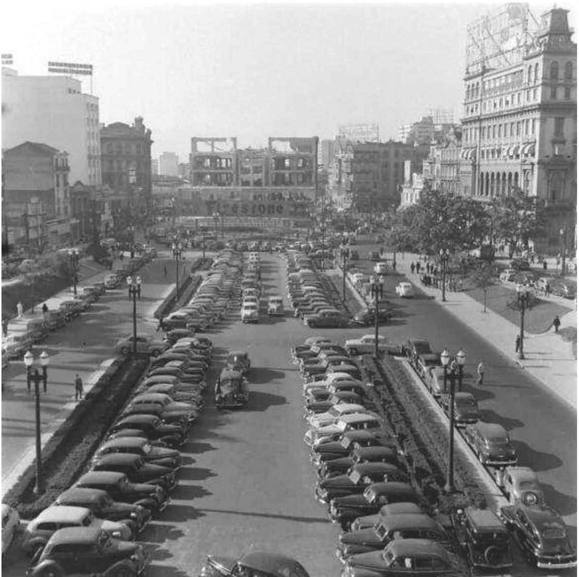
Figura 68. Edifício da Delegacia Fiscal sendo demolido e conexão entre a Avenida Anhangabaú e Tiradentes sendo consolidada. [Disponível em: São Paulo do passado – http://www.hagopgaragem.com ].
