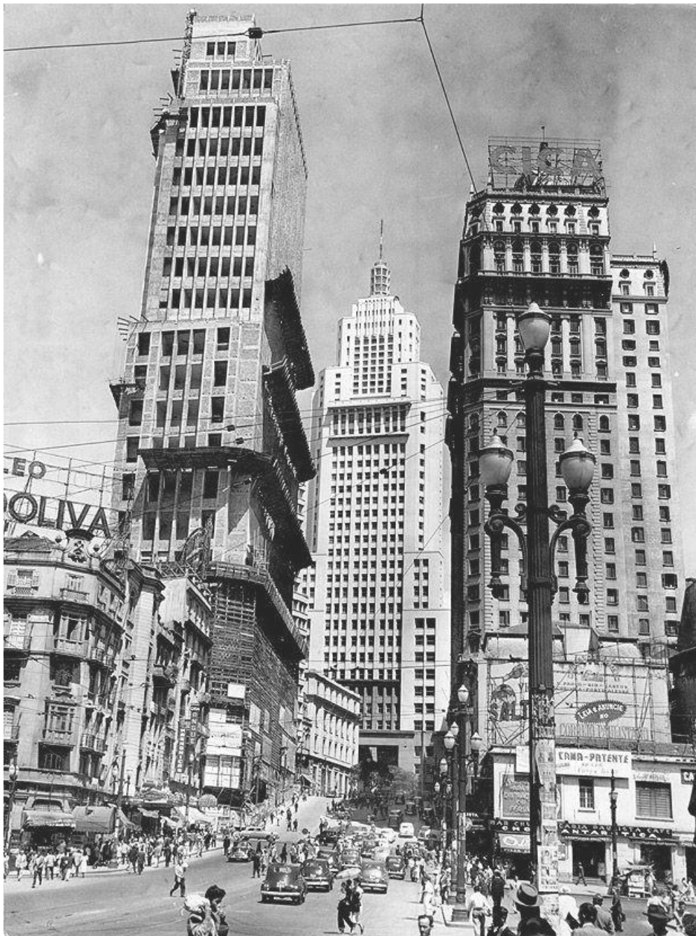
Figura 106. Construção do edifício do Banco do Brasil na Avenida São João na década de 1950. [Disponível em: São Paulo do passado – http://www.hagopgaragem.com ].
