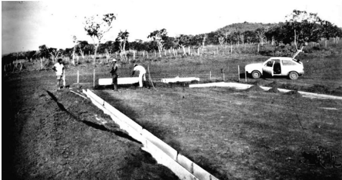
Figura 06 – Instalação das calhas de drenagem sobre colchão de areia. Definindo o gabarito para instalação na sequência das próximas peças. Fonte: LIMA, 1984, p. 45.
