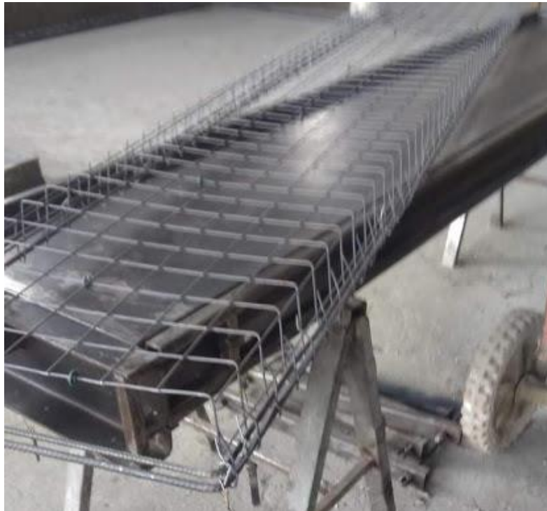
Figura 19 - Armação em tela com reforço de barras de aço na borda da peça de laje. Imagem do autor.
