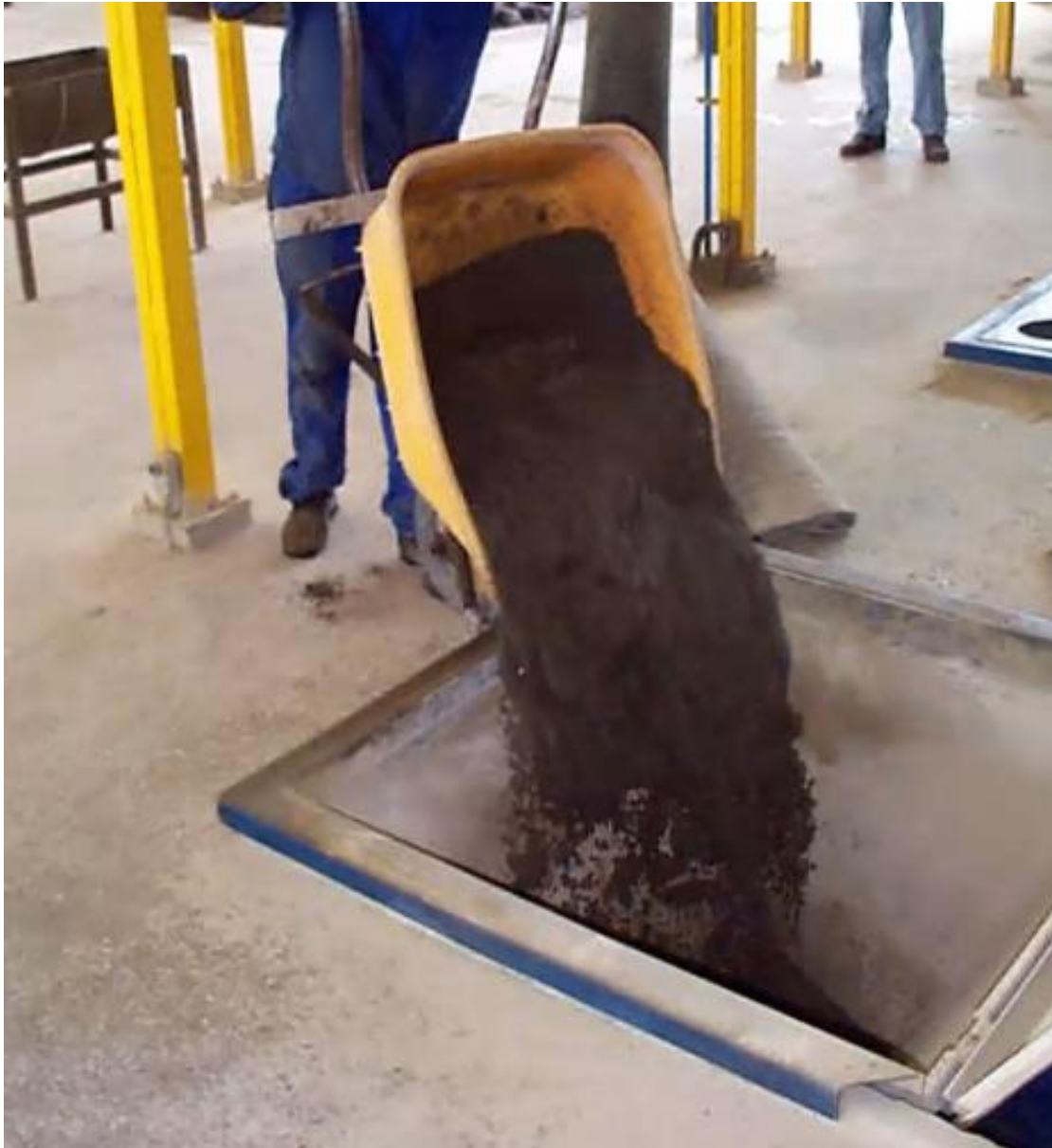
Figura 53 – Central de argamassagem - CTRS. Fonte: arquivo CTRS.
