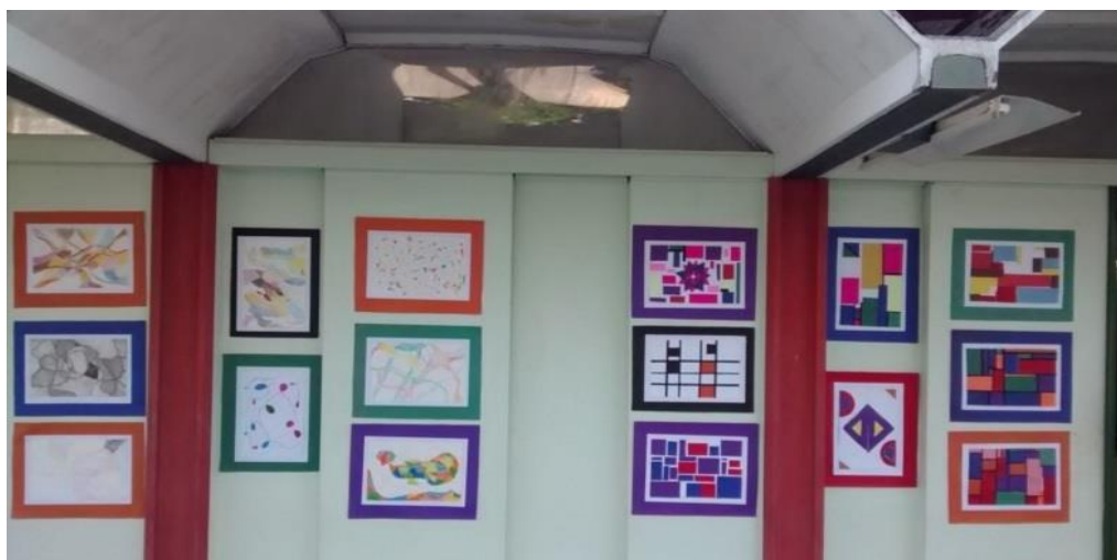
Figura 48 - Corredor externo onde se visualizam o balanço das vigas seccionadas apoiadas aos pilares e a superposição dos componentes de divisória. Imagem do autor, 2018.
