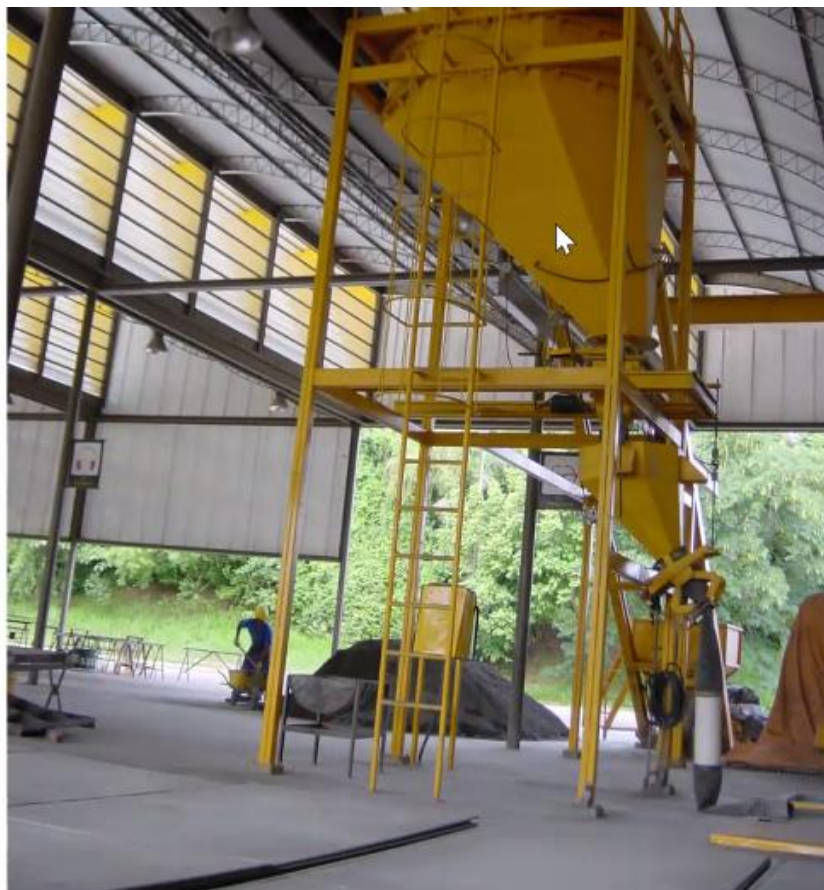
Figura 54 - Central de argamassagem - CTRS. Fonte: arquivo CTRS.
