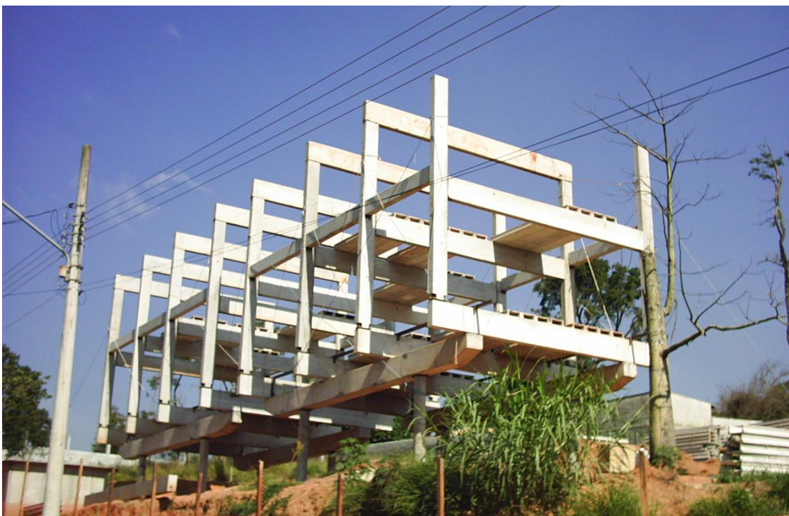
Figura 95 – Sistema estrutural misto: vigas em argamassa armada; pilares e viga de transição em concreto armado para receber posteriormente lajes em argamassa armada. Montagem por guindaste de pequena escala (25 T). Fonte: peça e imagem realizadas pelo autor.
