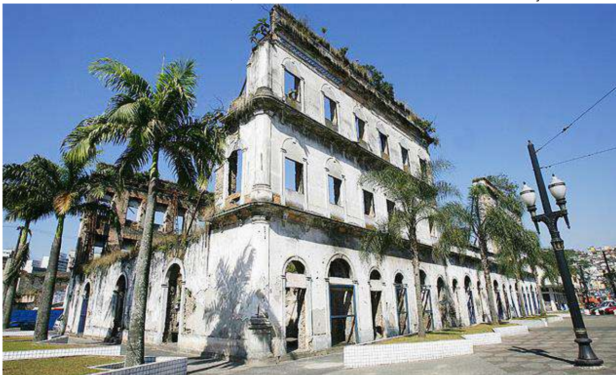
Figura 17. Casarão do Valongo construído em 1872. De 1895 a 1939 sediou a Câmara Municipal. Em 1985 sofreu um incêndio, intensificando ainda mais seu estado de deterioração.
