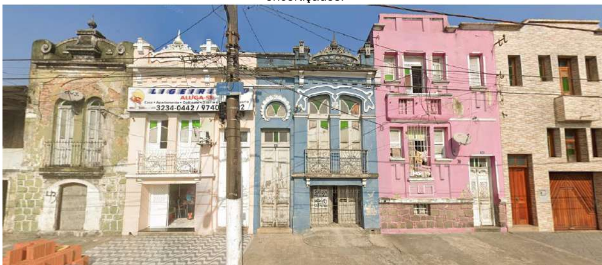
Figura 15. Av. Campos Sales. Região com edifícios históricos, alguns descaracterizados e encortiçados.
