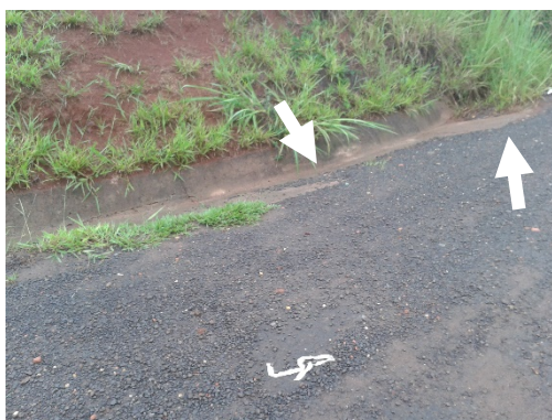
Figura 2 - Fresado asfáltico no sistema de drenagem superficial localizado na proximidade do km 193, pista sul, da SP 330
