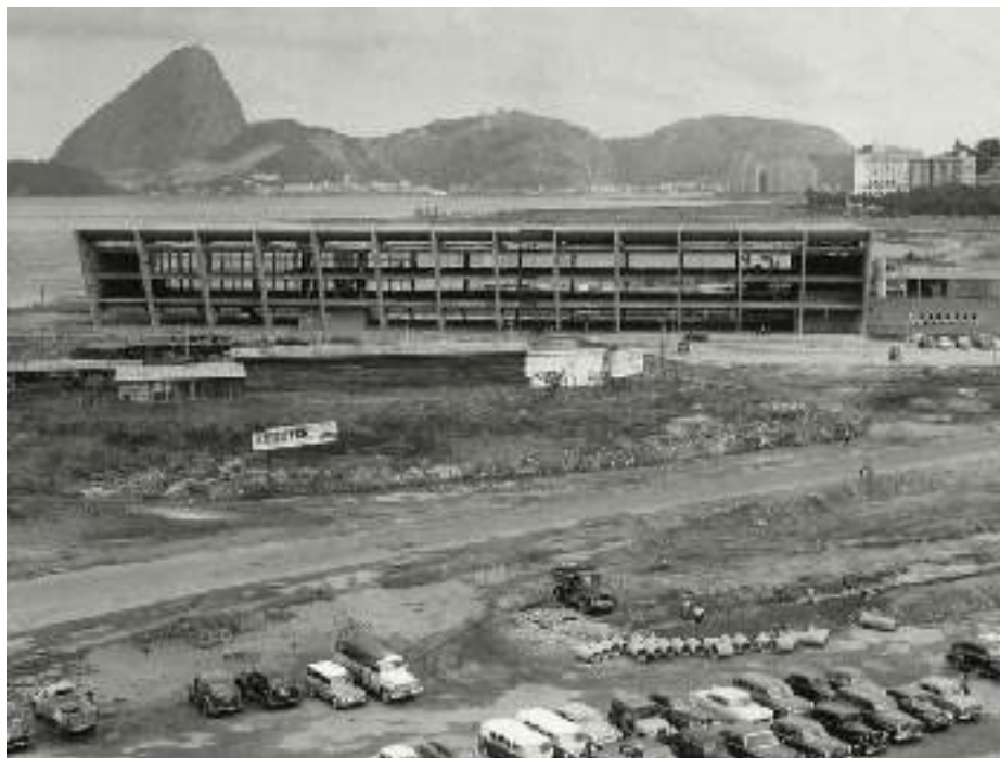
Imagem 24: Estrutura do Bloco de Exposições do Museu de Arte Moderna do Rio de Janeiro, [ca. 1961].
