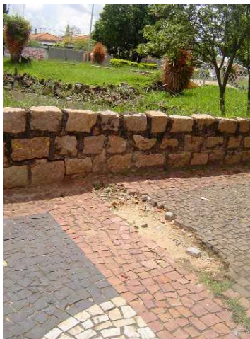
Figura 80. Piso mal conservado
