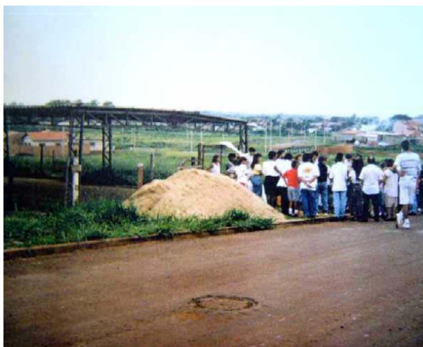
Figura 98. Construção do Centro comunitário do Jardim Heitor Rigon em Ribeirão Preto / SP
