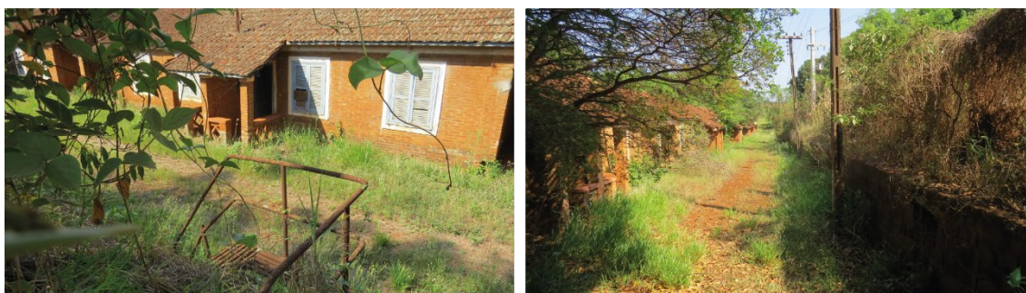
Figura 98 - Levantamento fotográfico Usina Palmeiras: desnível estrada e rua interna, muro e escada
