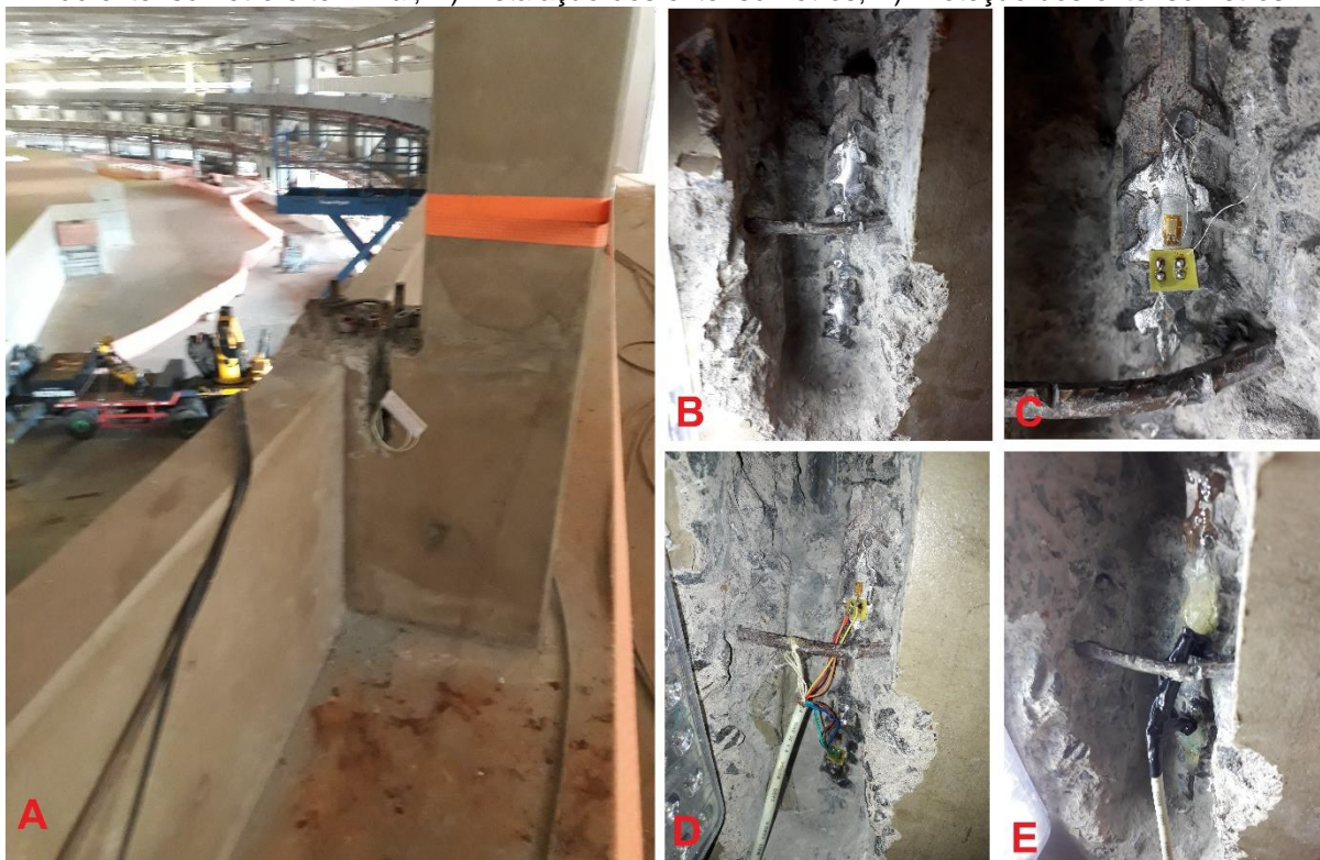
Figura 105. A) “Janela” de acesso a armadura no topo do pilar; B) Preparo da superfície; C) Colagem do extensômetro e terminal; D) Instalação dos extensômetros; E) Proteção dos extensômetros
