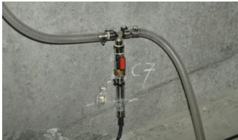
Figura 49. Célula de Pressão instalada em sistema de nivelamento hidrostático
