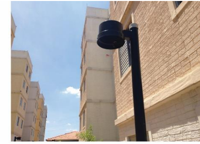
Luminaria avariada (Cond. B1)
