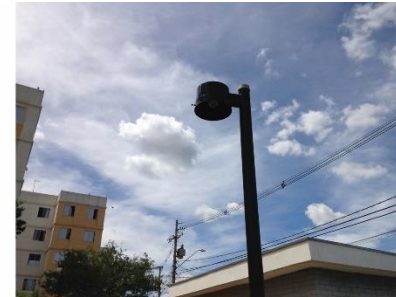
Luminaria avariada (Cond. C6)
