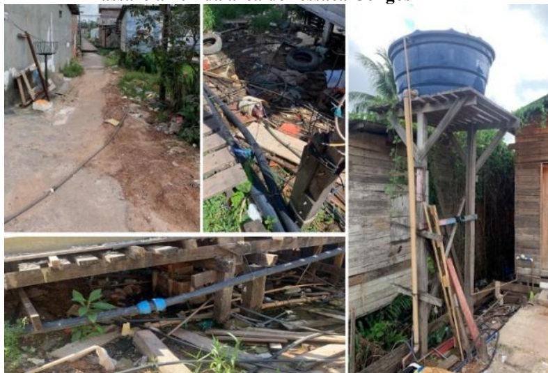
Figura 78 - Mosaico composto por imagens da canalização de abastecimento de água ao longo da Passarela 20 a da área de ressaca Congós
