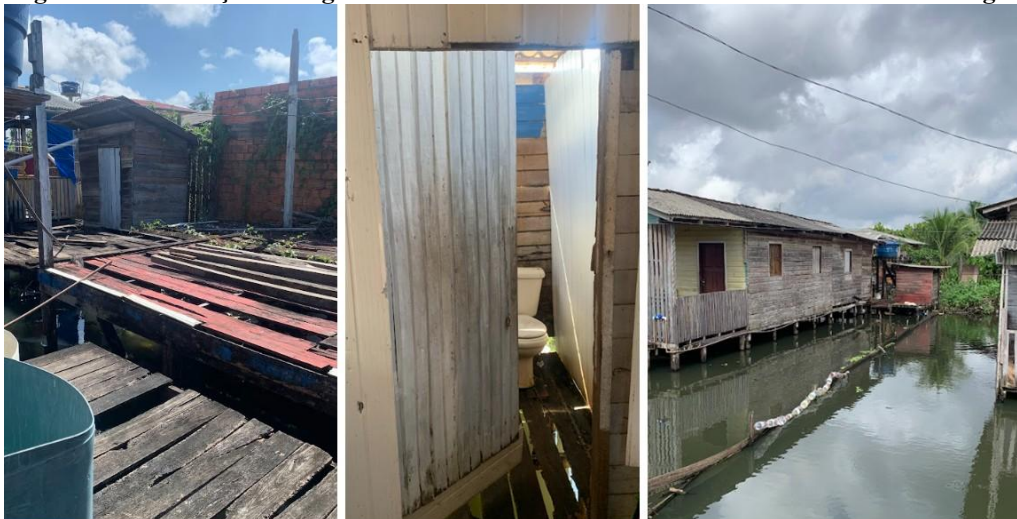
Figura 84 - Condição do esgoto nas casas na Passarela 20 a da área de ressaca do Congós
