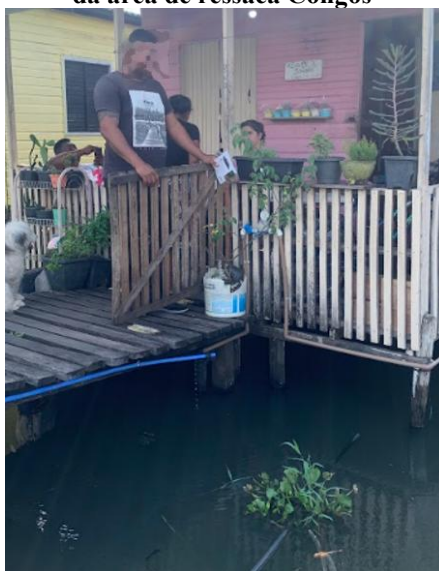
Figura 81 - Canalização de abastecimento de água nova (azul) e antiga (preta) em casa na Passarela 20 a da área de ressaca Congós
