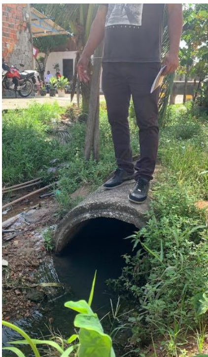
Figura 74 - Galeria de água pluvial provenientes do setor em terra firme, descartadas na área da Passarela 20ª da área de ressaca Congós
