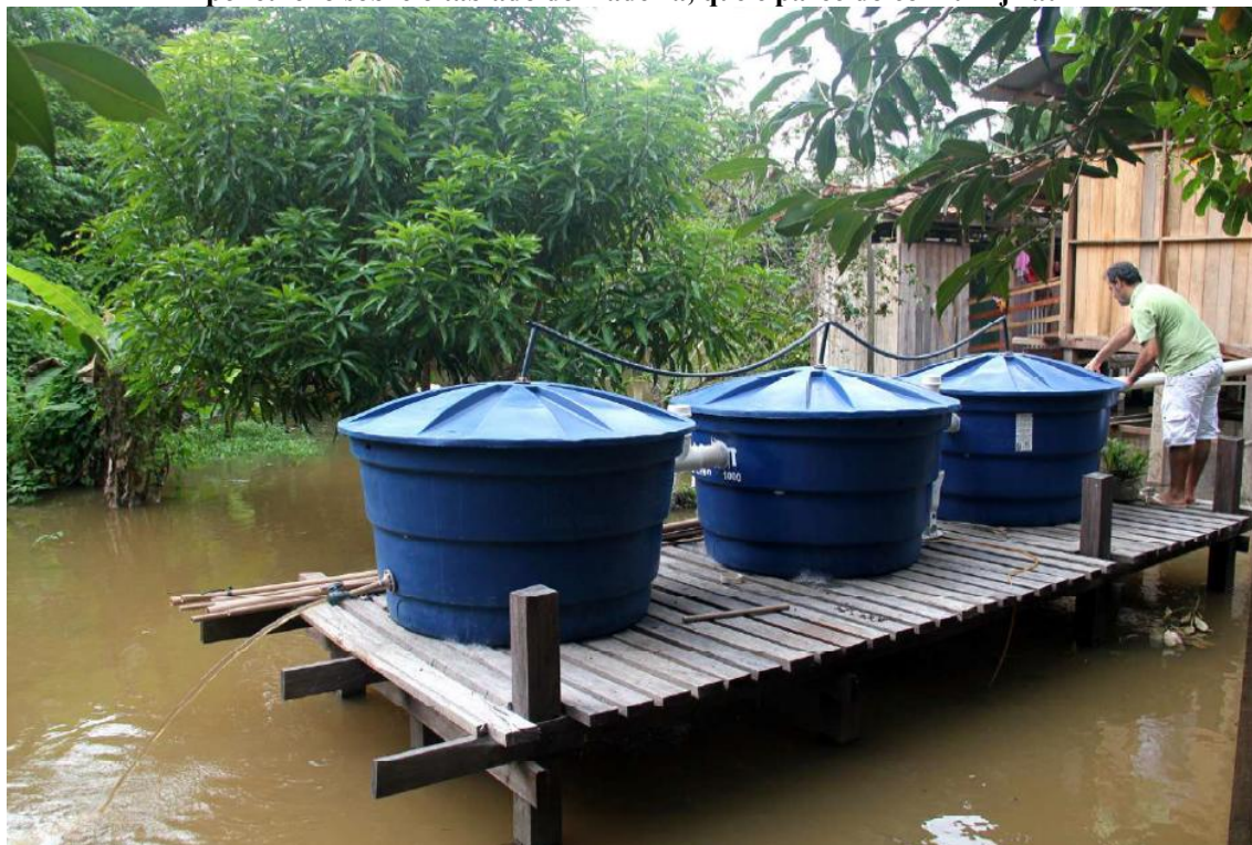
Figura 91. Fossa séptica biodigestora instalada na Ilha das Cinzas, Gurupá, PA, com três caixas de polietileno sobre o tablado de madeira, que é parecido com um jirau
