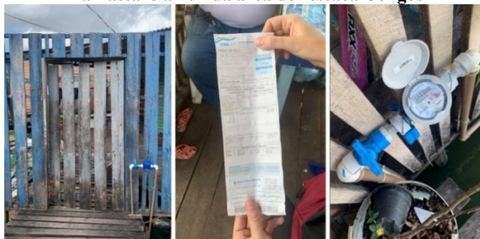
Figura 80 - Medidores instalados nas moradias e comprovante da cobrança de consumo de água em casa na Passarela 20 a da área de ressaca Congós
