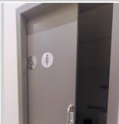
Fig. 9: Placa informativa do sanitário PNE, não condizente com a norma vigente.
