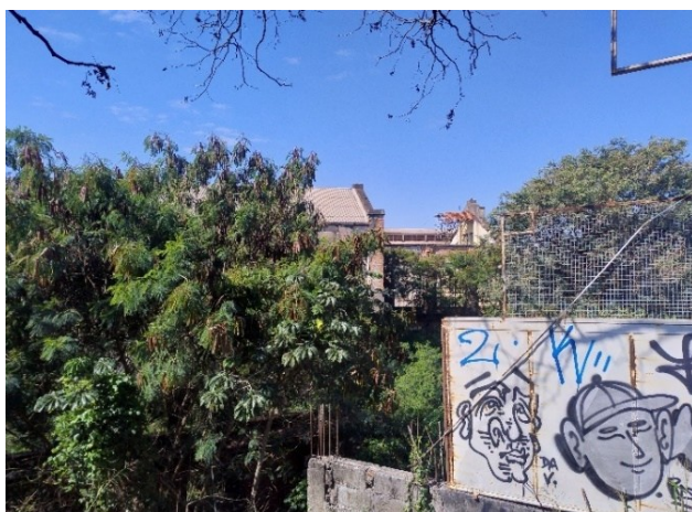
Figura 34: Muro de fechamento do entorno do complexo com partes caídas, ao fundo, cobertura de uma das oficinas em ruínas.
