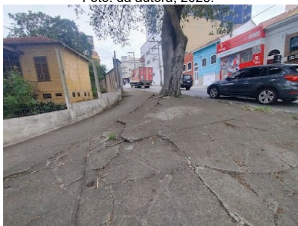
Figura 69: Situação do calçamento no entorno da praça. Foto: da autora, 2025.
