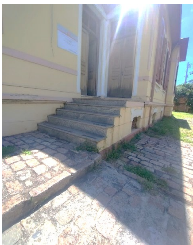
Figura 98: Acesso ao Museu com escada sem corrimão e guarda-corpo. Foto: da autora, 2025.
