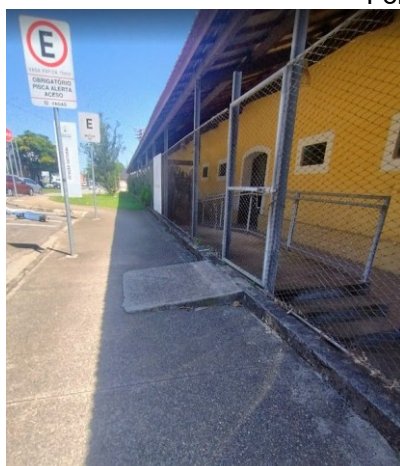
Figura 52: Acesso ao Barracão Cultural. Nota-se a ausência de execução de piso tátil. Foto: da autora, 2025.
