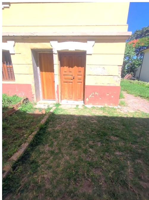
Figura 104: Acesso ao sanitário de uso dos visitantes, que também é PNE. Para acessá-lo é necessário contornar a edificação no exterior, no entanto, não há nenhuma indicação de que o local é um sanitário. Foto: da autora, 2025.
