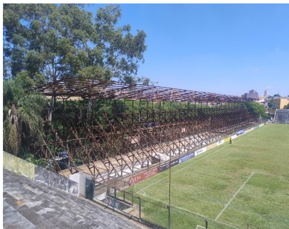
Figura 41: Arquibancada do Estádio Dr. Rui Costa Rodrigues parcialmente demolida. Foto: da autora, 2026.
