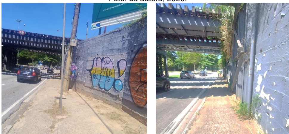
Figura 89: Ponto 07. Estreitamento da passagem de pedestres (à direita) e com presença de obstáculos (à esquerda) sob o pontilhão da linha férrea. Foto: da autora, 2026.
