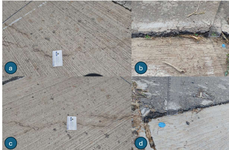
Figura 63: Inspeção visual final - fissuras seção XII, sendo a) fissura de canto placa E, b) Desnível entre pavimento placa E, c) Fissura de canto placa F, d) Desnível entre pavimentos placa F
