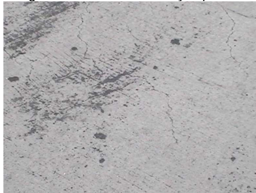
Figura 8: Fissuras de retração plástica
