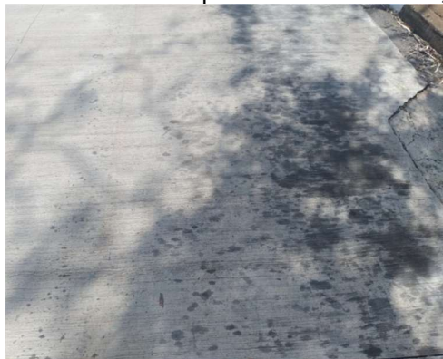
Figura 60: Mancha de óleo proveniente do ônibus, seção IX
