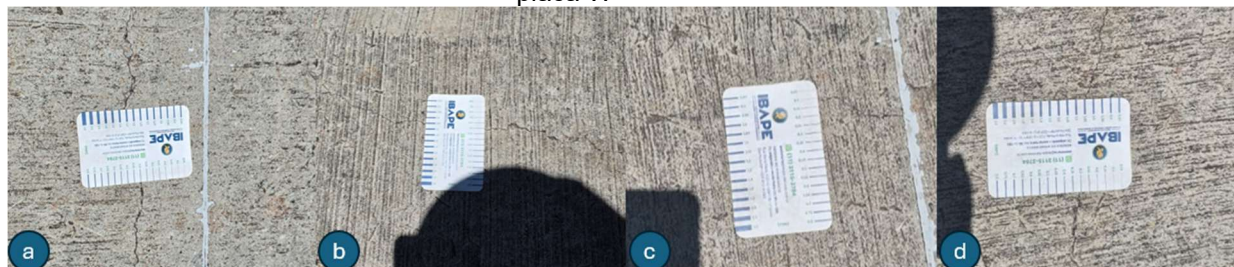
Figura 49: Inspeção visual final - fissuras seção I, sendo a) placa G, b) placa K, c) placa O, d) placa W
