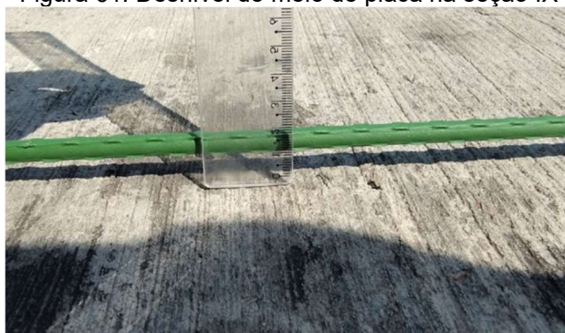
Figura 61: Desnível de meio de placa na seção IX
