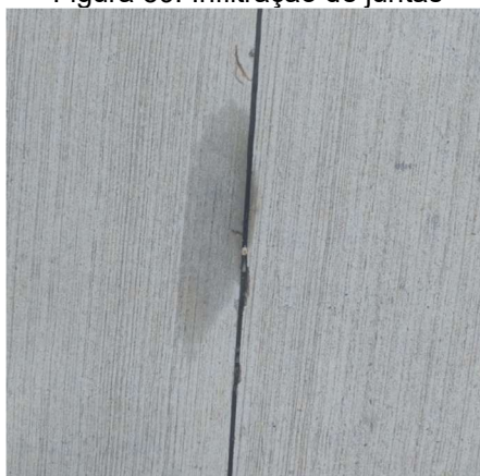
Figura 59: Infiltração de juntas
