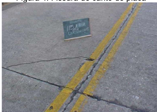
Figura 4: Fissura de canto de placa
