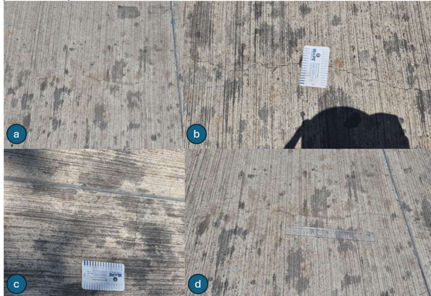
Figura 58: Inspeção visual final - fissuras seção VIII, sendo a) placa C, b) medida espessura placa E, c) placa G, d) extensão placa E
