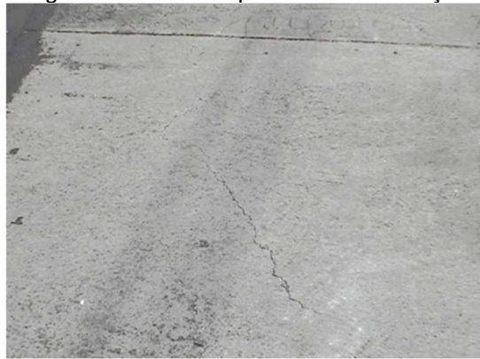
Figura 7: Fissura Superficial e Escamação
