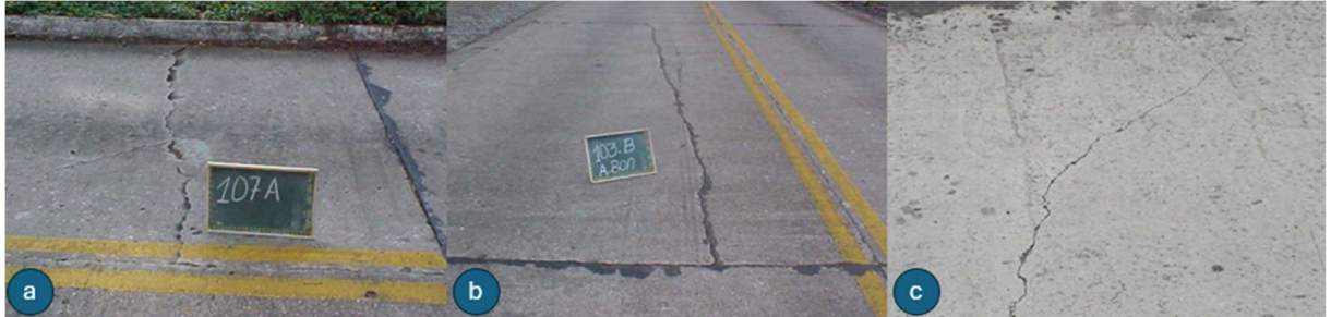
Figura 6: Fissuras lineares em diferentes graus de severidade - a) Fissura Linear Transversal; b) Fissura Linear Transversal; c) Fissura Linear Diagonal
