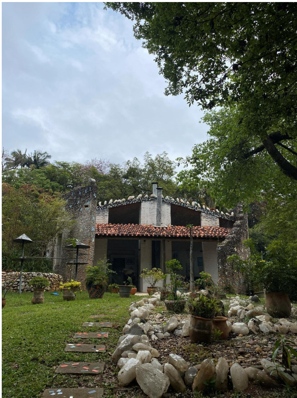
Figura 38. La Torracia e seu atual estado de conservação. A cobertura em telhas cerâmicas apresenta problemas. As paredes abraçam e protegem a edificação. Fotografia do autor, 2025
