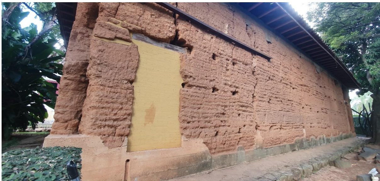
Figura 118. Fachada da Tulha voltada à Av. Dr. Arlindo Joaquim de Lemos. À esquerda, observa-se a expressiva fissura junto às intervenções contemporâneas: o novo fechamento e as estruturas metálicas e de concreto
