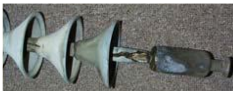
Figura 26. Isolador com erosão no núcleo ocasionado pelo Efeito Corona (EKLUND INFRARED INC, 2009).
