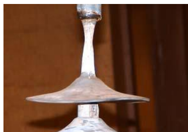
Figura 27. Isolador com erosão no tarugo de fibra de vidro (EKLUND INFRARED INC, 2009).
