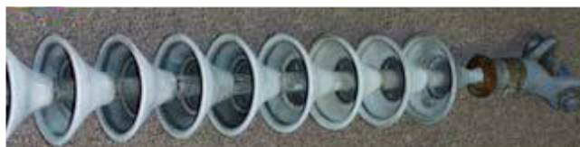
Figura 25. Isolador com erosão na ferragem ocasionada pelo Efeito Corona (EKLUND INFRARED INC, 2009).
