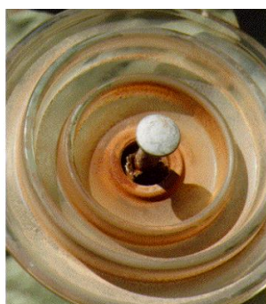
Figura 24. Isolador com sinais de corrosão (MELLO, CARDOSO e GONÇALVES, 2010).
