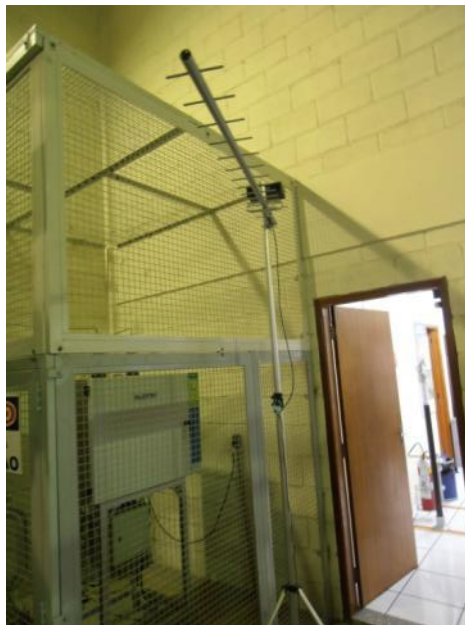
Figura 121. Sistema transmissor (antena e sensor)
