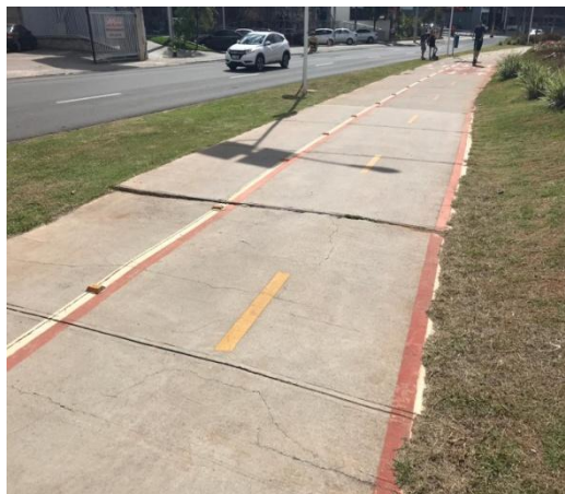
Figura 56 - Imagem dos desníveis verificados em ciclovia implantada na avenida Norte Sul, na cidade de Campinas/SP
