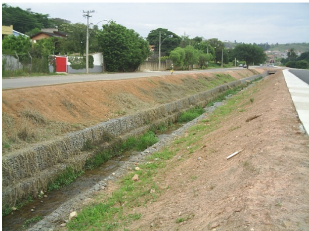
Figura 24: Córrego do Perpétuo. Margem apenas composta por gabiões permeáveis e avenidas impermeáveis. (Foto: Gustavo C. de A. Franco/2008)
