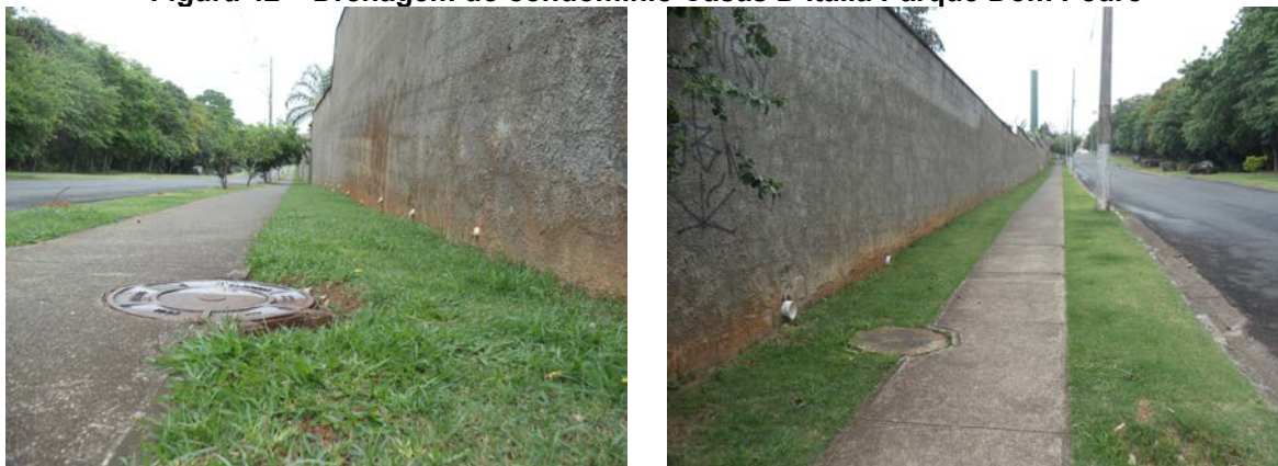
Figura 42 – Drenagem do condomínio Casas D'Itália Parque Dom Pedro
