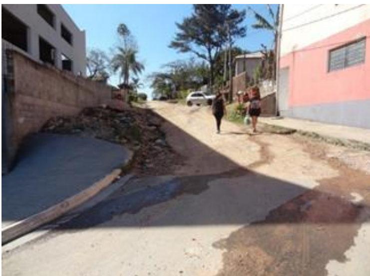
Figura 20 Foto de uma das ruas de terra, sem guia, sarjeta e calçada de pedestres. Fonte: Larissa Ribeiro, 2016.
