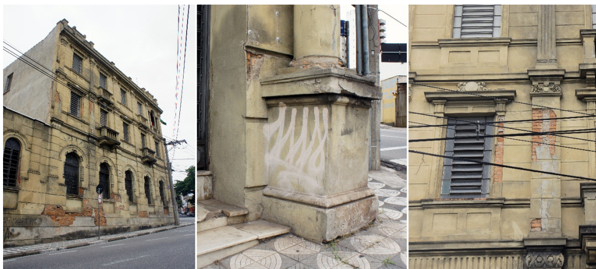
Figura 82 – Diversas anomalias na fachada do Palacete Scarpa Fotos e adaptação: autor, 2019
