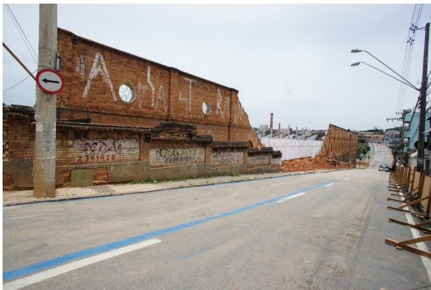
Figura 33 – Desabamento da parede da Fábrica Santo Antônio Foto: autor, 2012
