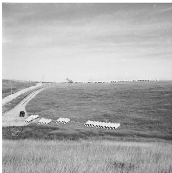
Figura 22: Tubulação para obras de infraestrutura da SANASA (local de Campinas não identificado)
