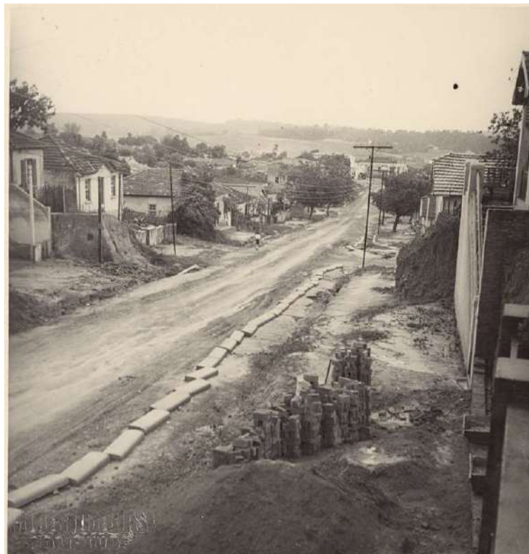
Figura 96: Material depositado ao longo da rua para realizar o calçamento e recapeamento, s/id.
