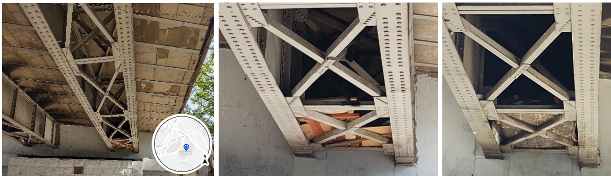
Figura 109: Abrigo nos baixos do viaduto da Avenida Lix da Cunha. Local: Rua Dr. Mascarenhas. Data: 14/10/21. Horário: 08:29h. Local: Rua Dr. Mascarenhas. Fonte: Autora, 2021. Fonte do Mapa: Elaboração própria a partir de MAPBOX, 2021.
