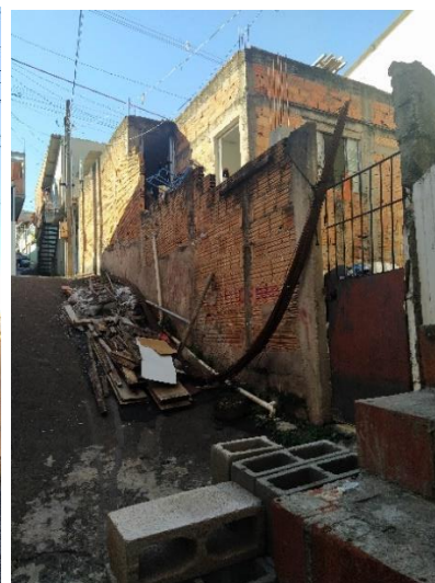
Figura 35. Casa com tijolo aparente e indícios de obra
