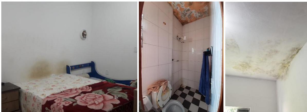
Figura 112. Sinais de umidade, infiltração e mofo nas paredes e teto das casas das família F24, F43 e F45
