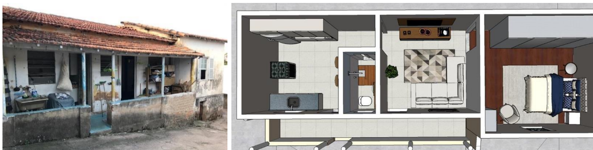
Figura 124. Fachada da casa de funcionária da creche e planta de layout do projeto elaborado pela Arquitecta A25
